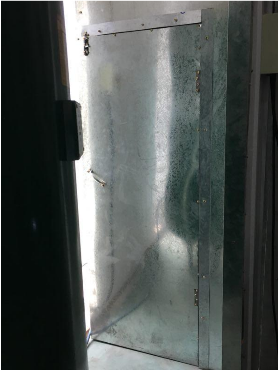
图 5.3-1 空压机隔音间照片
