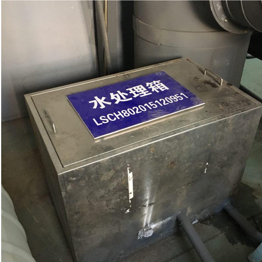
图 5.2-1 废水处理设备
