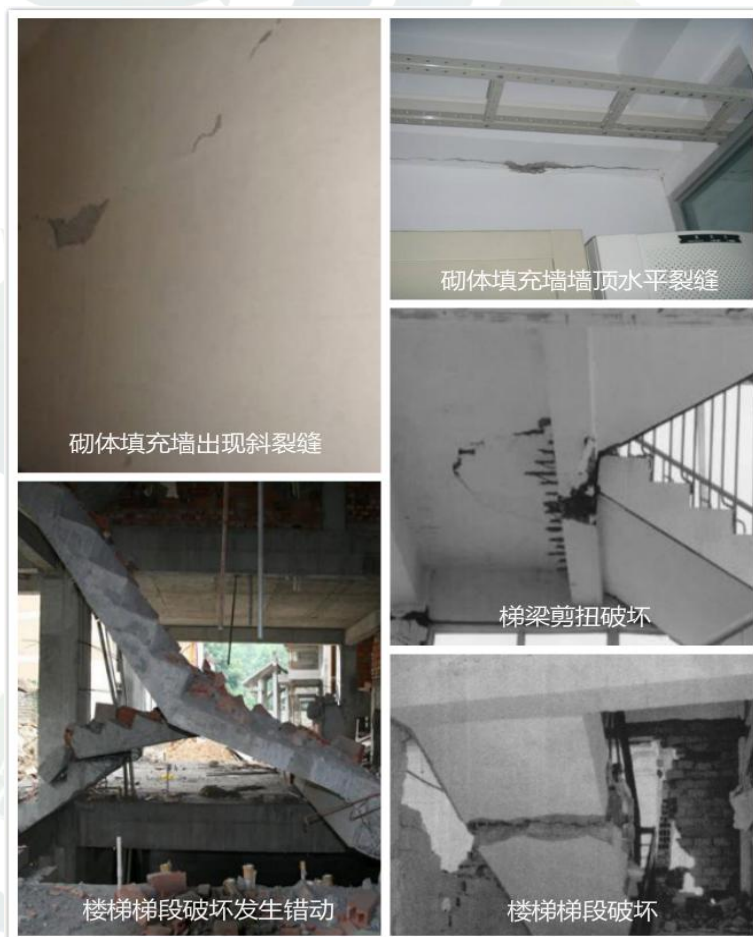
图 8 楼梯破坏情况
