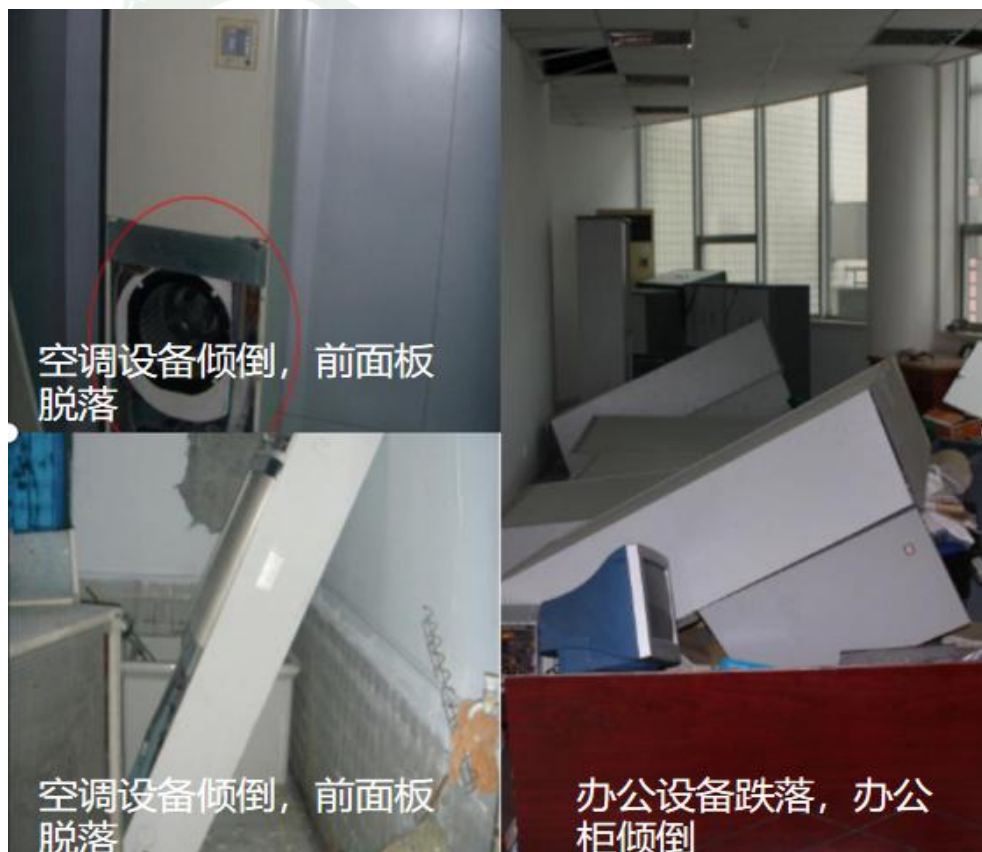
图 13 空调设备、办公设备破坏情况
