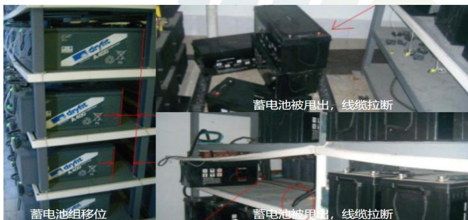
图 12 蓄电池破坏情况
