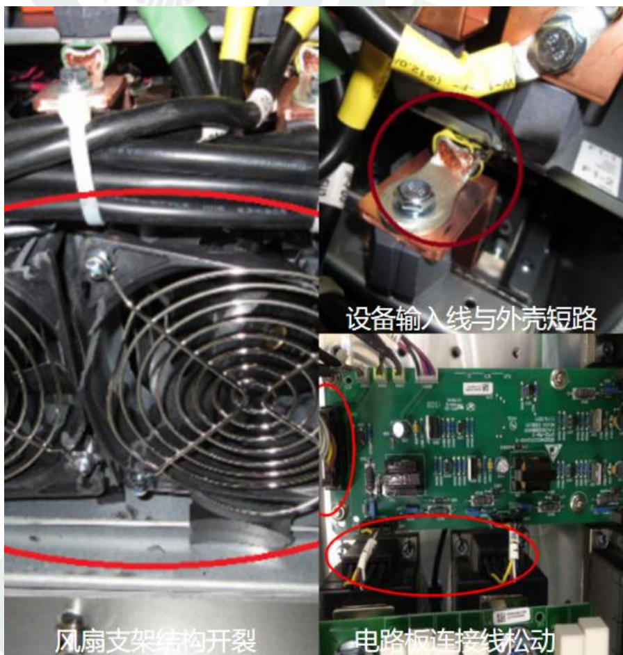
图 28 内部结构备破坏情况
