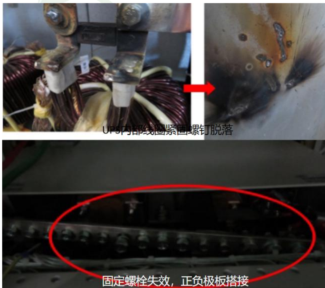
图 30 紧固件脱落，功能异常
