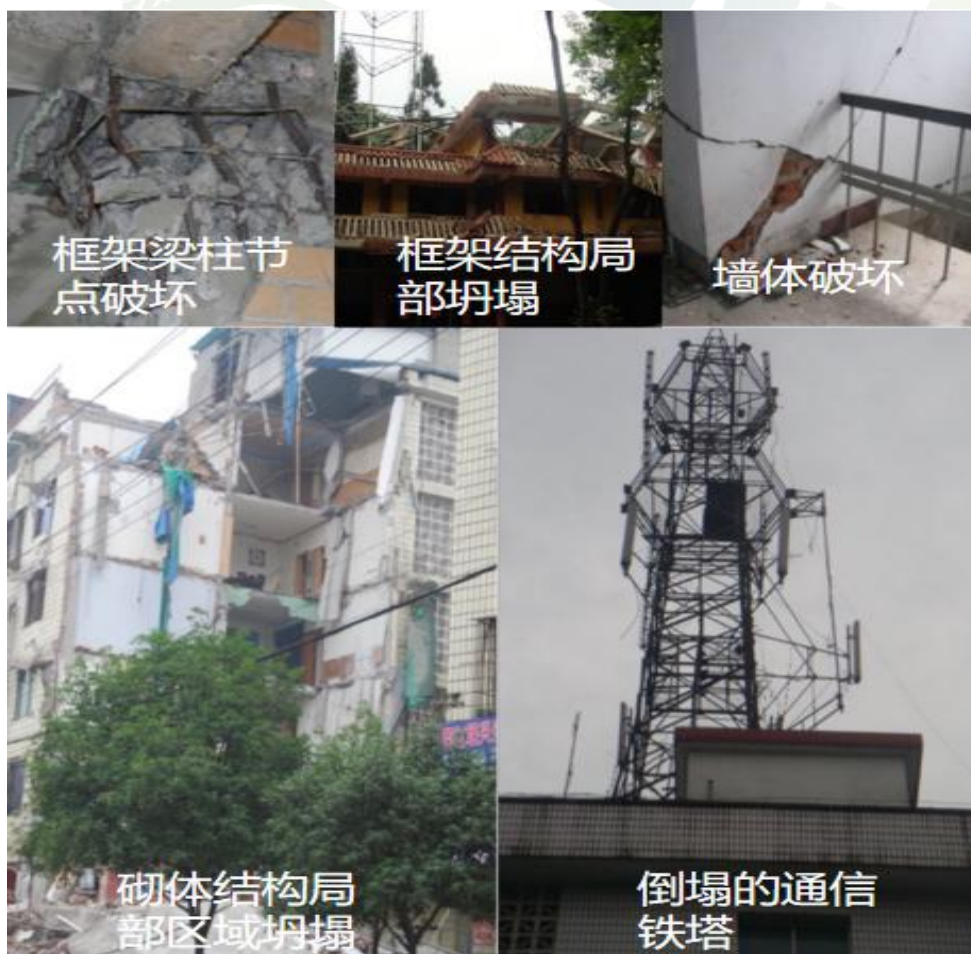
图 9 通信基站破坏情况
